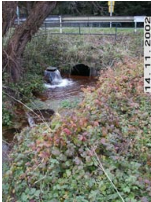
Einleitstelle LINEG am Graben 22
