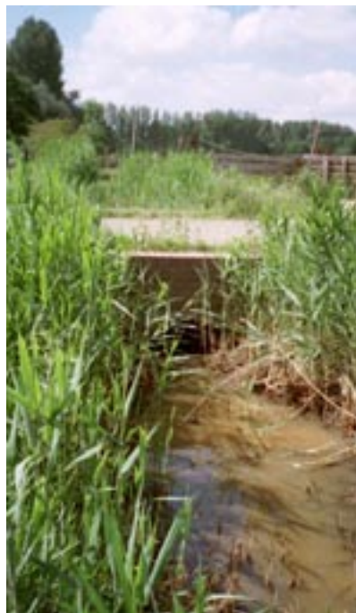
Sankert im Bereich Reithalle Bayer, Graben verschlammmt (Mai 2002)
